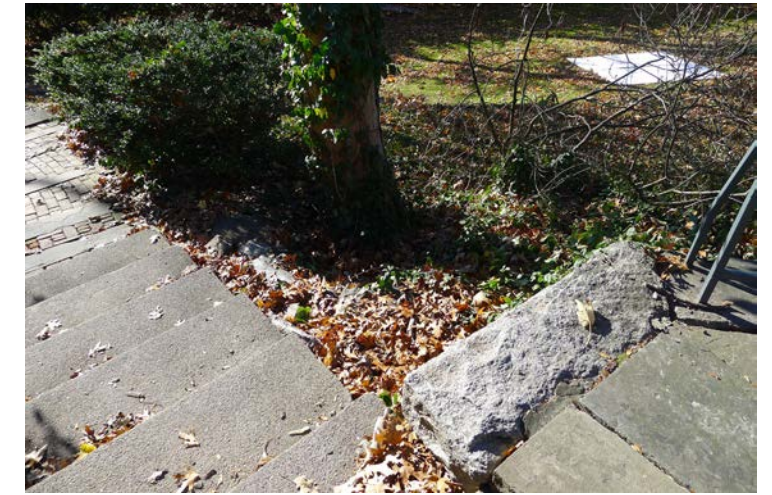
D Dangerous edge condition.
